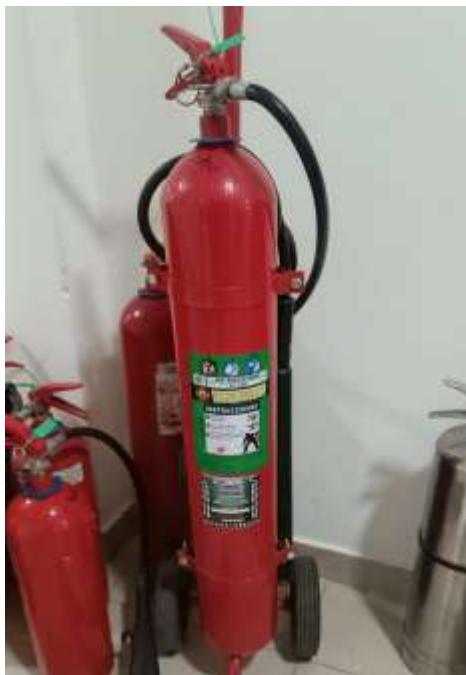
Ilustración 12: Extintor de Carbono dpto. de Riesgo del Gad. Daule
