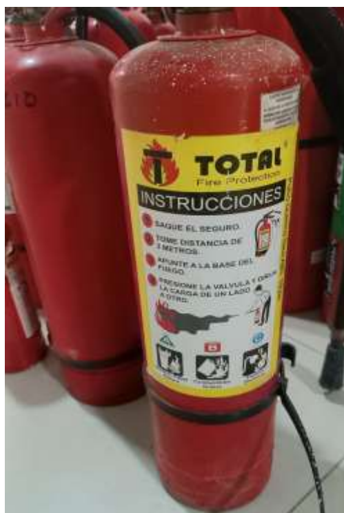
Ilustración 13: Extintor de polvo químico seco, dpto. de Riesgo del Gad. Daule
