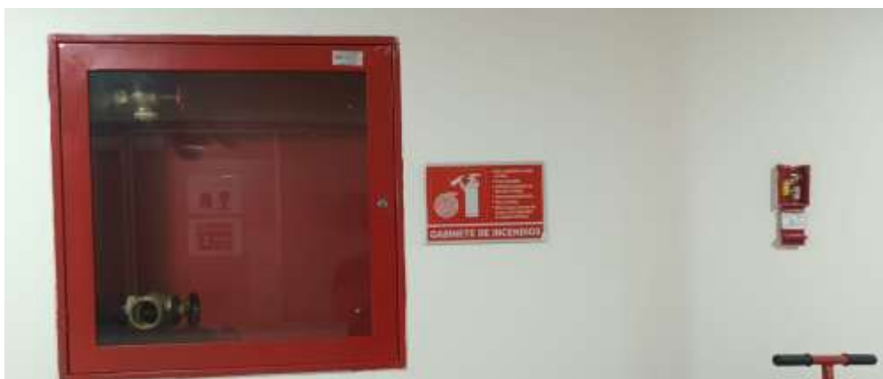
Ilustración 1: Extintores área Administrativa Primera Planta Gad. Daule
