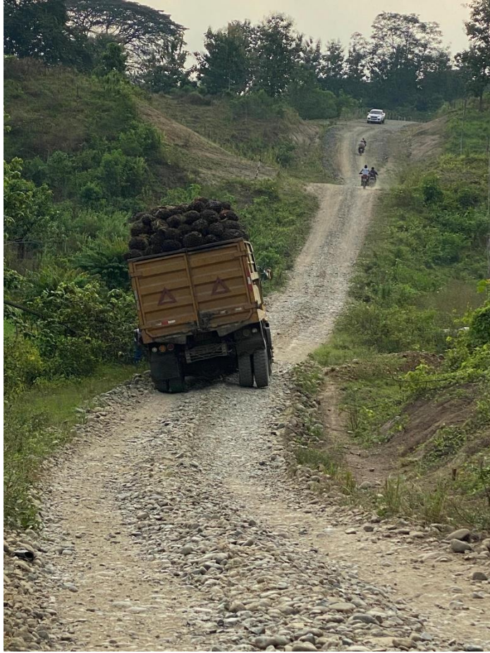
Vía a Palenque en el km 5,4 observamos la carretera en malas condiciones para los transportes que cargan productos agrícolas
