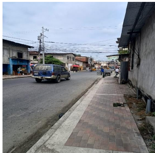
Ilustración 11. Falta de señalización horizontal.
