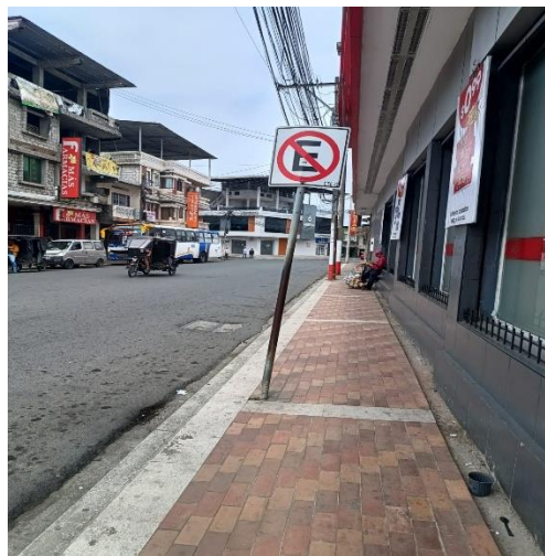
Ilustración 10. Señalización vertical en mal estado
